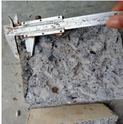
Gambar 5. Hasil Pengujian Penetrasi Air pada Beton CS0-1, dengan Nilai Penetrasi Air = 1,38 cm
