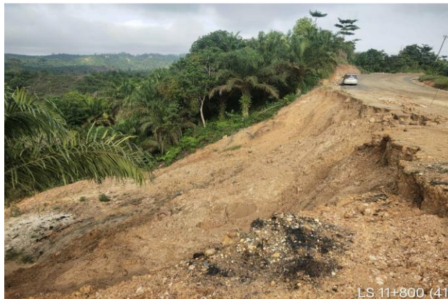
Gambar 1. Kejadian Longsoran pada Lokasi Proyek
