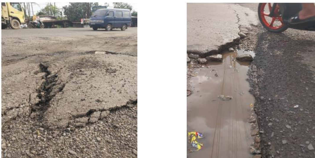
Gambar 5. Kondisi Bahu Jalan yang Rusak
