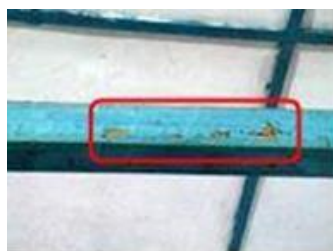
Gambar 4. Kerusakan pada balok
