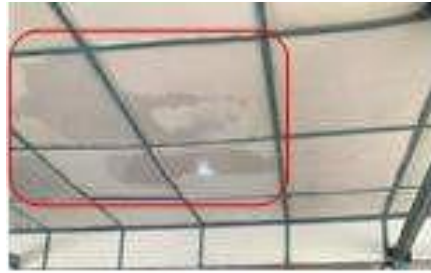
Gambar 11. Rembesan pada plafon
