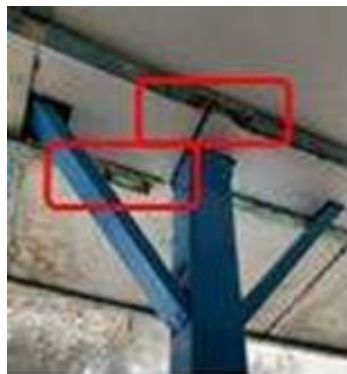
Gambar 9. Kerusakan pada rangka plafon
