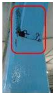
Gambar 3. Kerusakan pada kolom
